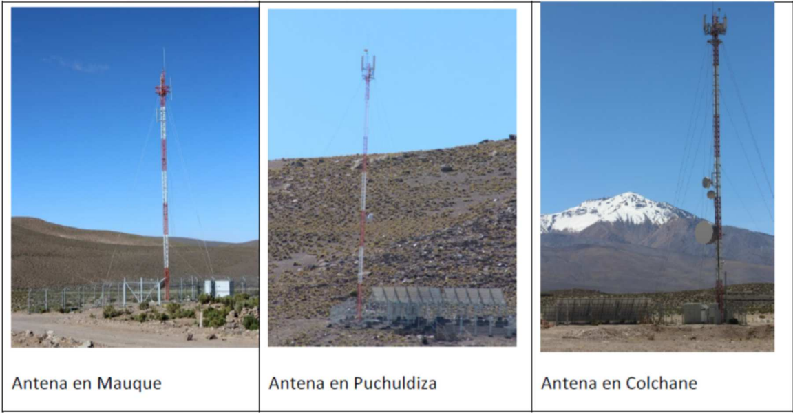
Imagen N° 10 Antenas Telefónicas Comuna Colchane
