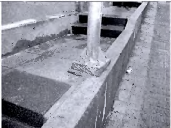
Foto N°44: Incorrecta ubicación de luminarias en calle Quirihue.
