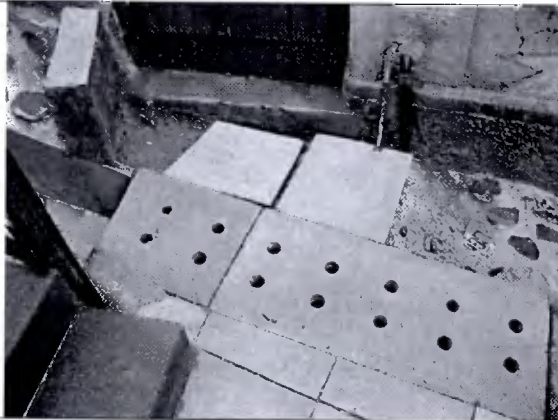
Foto N°27: Problemas en los accesos a viviendas en la calle Puyredón.
