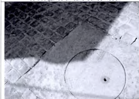
Foto N°41: Desnivel de cámara respecto al pavimento de adoquines en calle Carlos Nebel.
