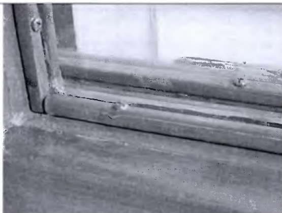
Foto N°10: Cordón de silicona aplicado solo en la superficie exterior del vidrio y no en la cara interior del carro
