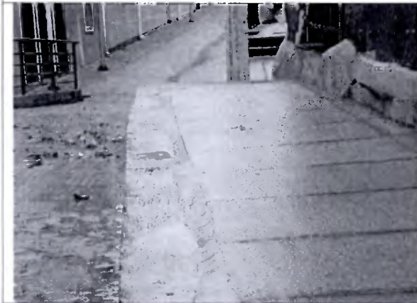
Foto N°37: Pastelones colocados a nivel no uniforme respecto al muro de calle Cayocopil.
