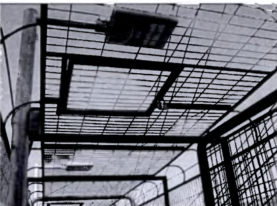
Foto N°12: Postes de iluminación y gateras de inspección en pasarela de acceso, estación superior, Ascensor Polanco.
