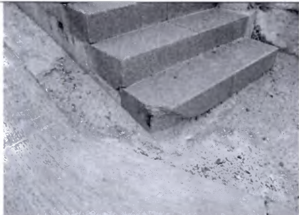
Foto N°43: Grada quebrada en calle Gandarillas.
