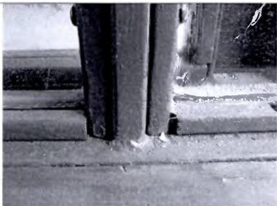
Foto N°9: Carencia de cordón de silicona y falta de acabado en su aplicación en carro de Ascensor Reina Victoria.
