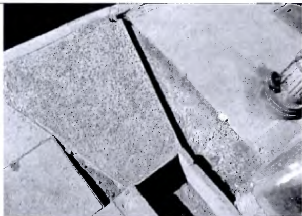
Foto N°45: Falta de elementos de palmetas de hormigón en calle Barbagelata.
