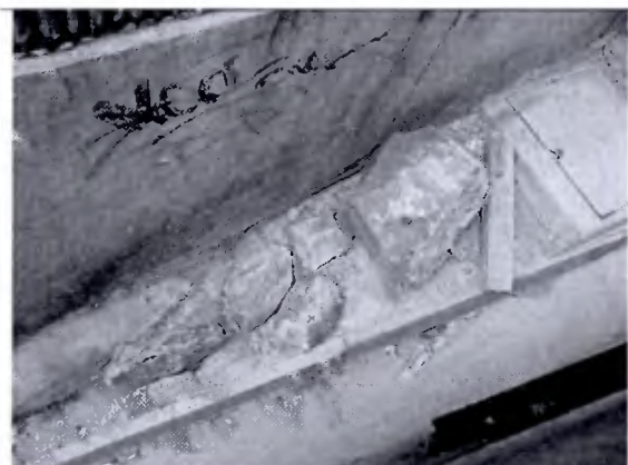
Foto N°23: Acumulación de material de excavación, restos de materiales y escombros calle Barbagelata
