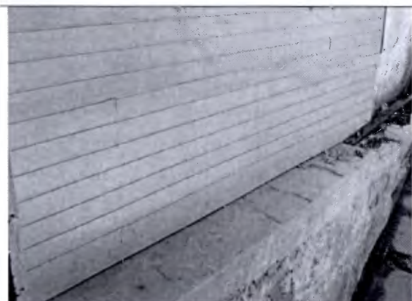
Foto N°19: Deterioro de pintura en fachadas exteriores, estación inferior, Ascensor barón, provocadas por ejecución de faenas de la empresa ASMAR.
