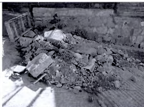
Foto N°21: Acumulación de material de excavación, restos de materiales y escombros calle Gandarillas
