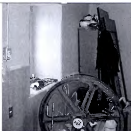
Foto N°20: Deterioro de pintura en fachadas interiores, zócalo estación superior, provocadas por el acopio de piezas metálicas.
