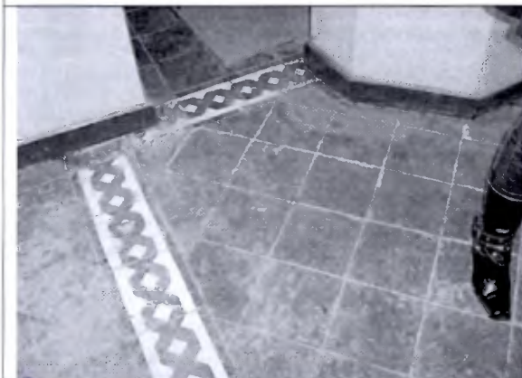
Foto N°5: Lodo en superficies de pisos y muros recientemente entregadas.
